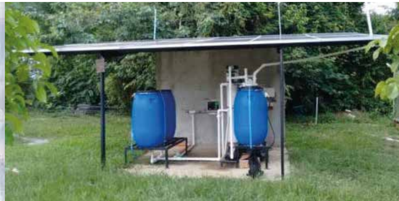
Unit C1, with photovoltaic panels, COLOMBIA Unité C1, avec panneaux photovoltaïques, COLOMBIE
