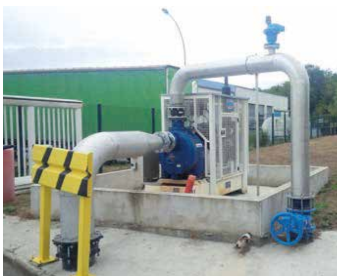
Motor-driven pump for the pumping of leachate 400 m3h Motopompe pour pompage de lixivie d'incendie 400 m3h
