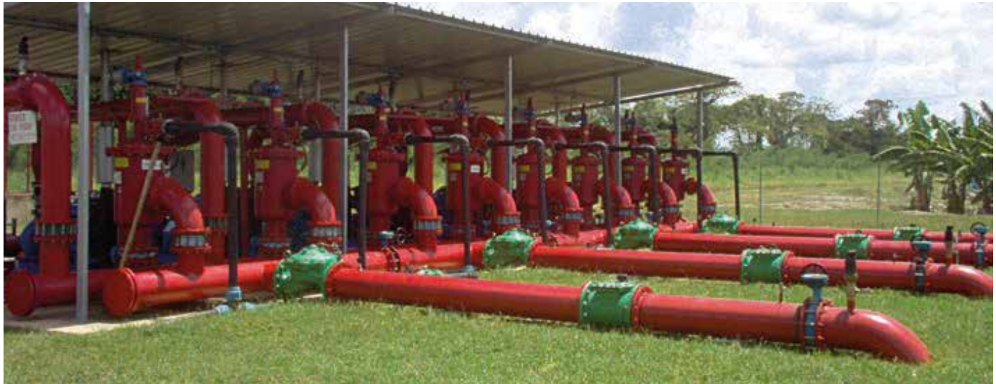
Pumping station delivering high flow rate with heat engine Station de pompage gros débit avec moteur thermique
